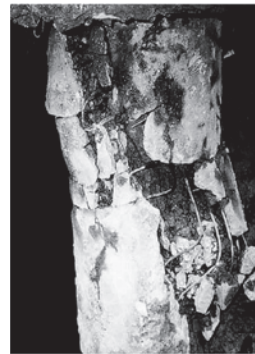
杭頭を剛接した杭の被害例
